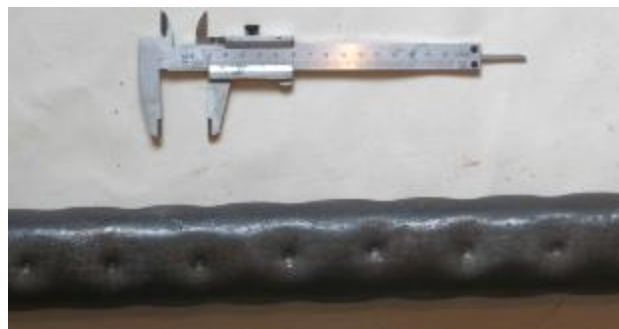
Рис. 9. Вид теплообменной трубы \varnothing 60 \times 3,5 мм с кавернами и выпорами на теплопередающих поверхностях
